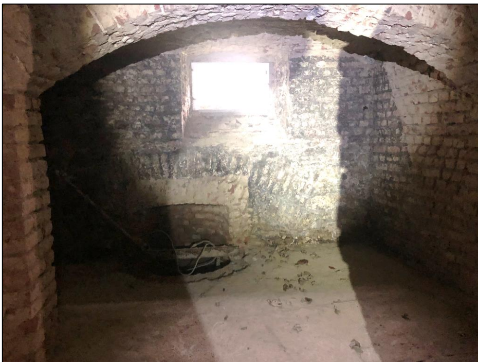
Abbildung 12: Beispiel eines Kellerraumes mit offener Brunnenanlage
