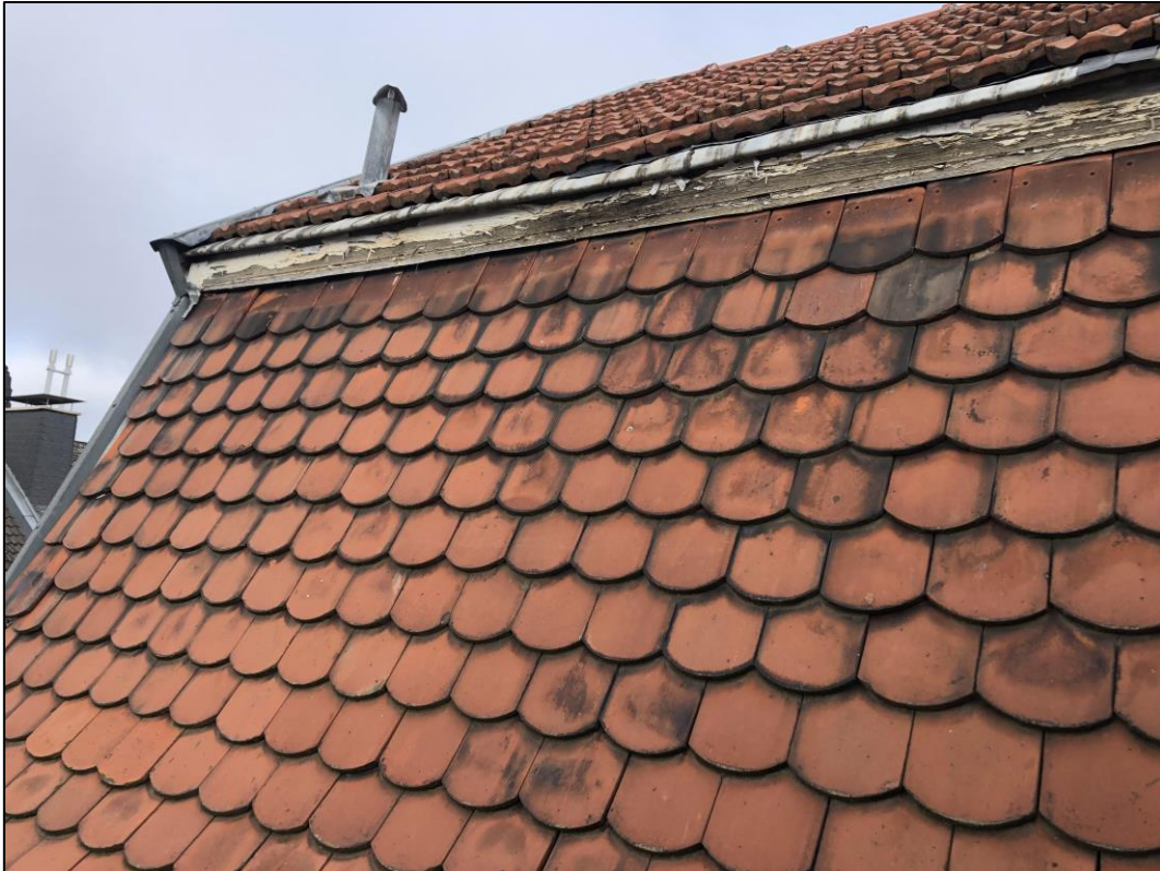
Abbildung 5: Westliche Dachseite mit maroder Holzleiste
