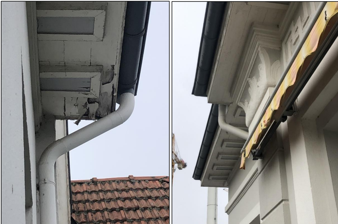
Abbildung 4: rechts: Traufenunterseite mit wenig Beschädigungen, links: abblätternde Farbe ohne ersichtliche Einstiegsmöglichkeiten zwischen Holzlatten
