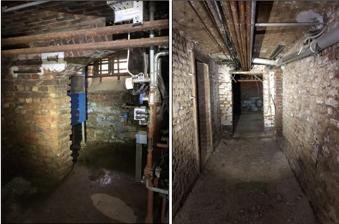
Abbildung 14: Hoher Feuchtigkeitsanteil und beschädigte Wasserleitungen Abbildung 13: Flur des Kellers
