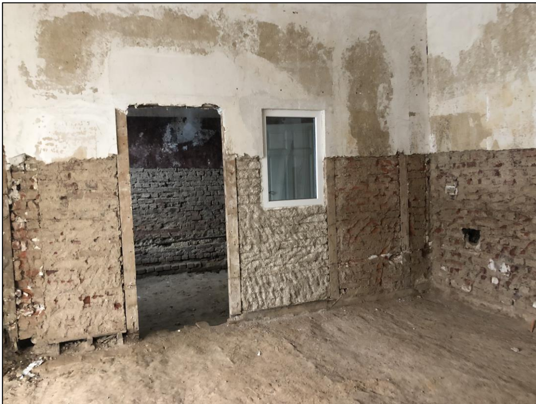
Abbildung 7: Erdgeschoss des Hauptgebäudes mit Beschädigungen
