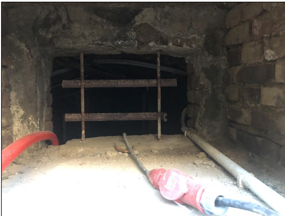
Abbildung 15: Beispiel einer in den Keller führenden Öffnung
