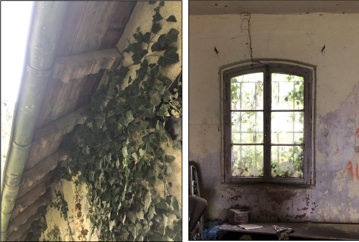
Abbildung 19: Links: Dachtraufe mit Efeubewuchs, rechts: dichtes Fenster in Raum 1
