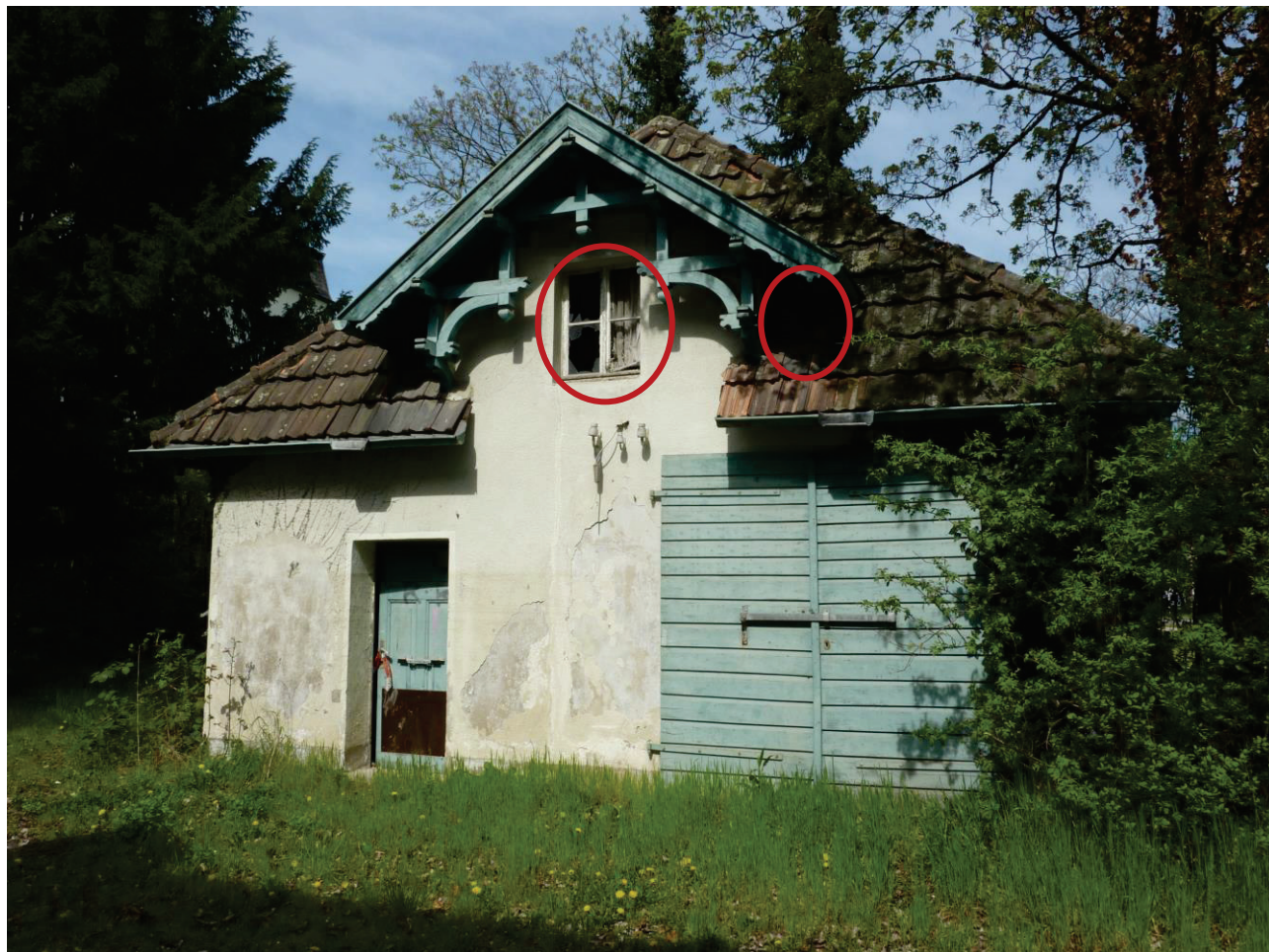
Abbildung 2: Nebengebäude mit Beschädigungen in Dach und Fenstern (Quelle: eigene Darstellung)
